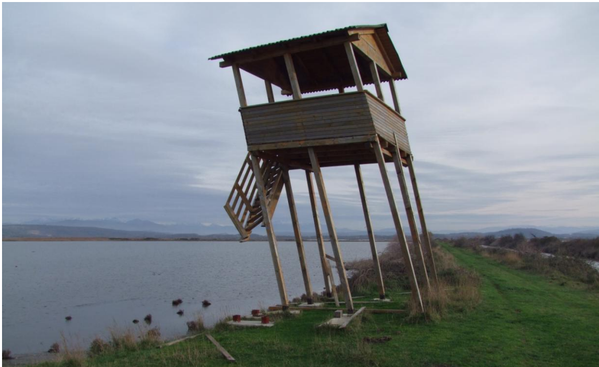
Abb. 7: Fehlentwicklung des montenegrinischen „Vogelschutzes“ - falsch platziert in vorgesehene Kernzone der Saline (!), falsch gemacht - ohne Kreuzverbindung, lebensgefährlich und dabei internationale Gelder sinnlos verbraten! Der Beobachtungsturm ist durch Wind verweht – Schade!
